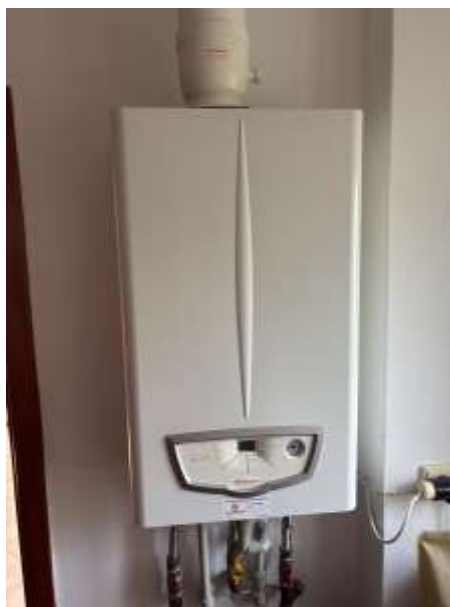
Obrázek 19: Zdroj vytápění objektu – Obecní úřad
