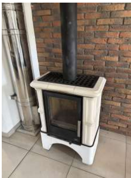
Obrázek 12: Zdroj vytápění objektu – Hostinec obce č.p. 37
